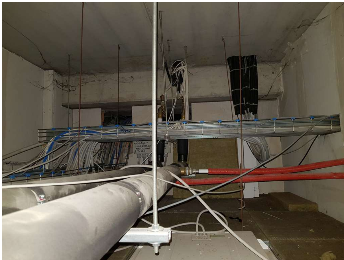
DETTAGLIO PIANO TERRA (condizione impianti sopra controsoffitto atrio ingresso)
