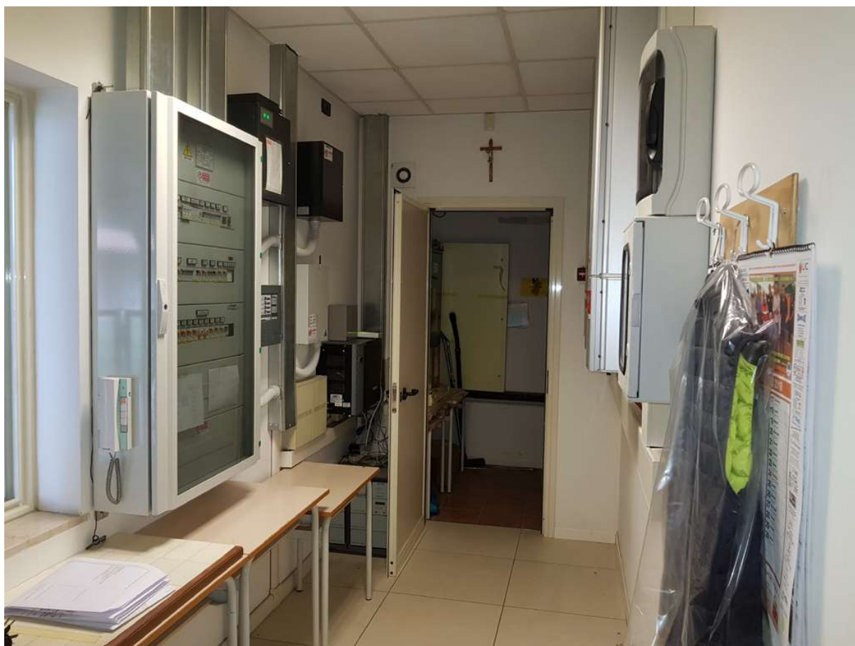
DETTAGLIO PIANO TERRA (locale inverter e quadri elettrici soggetto a criticità prevenzione incendi)
